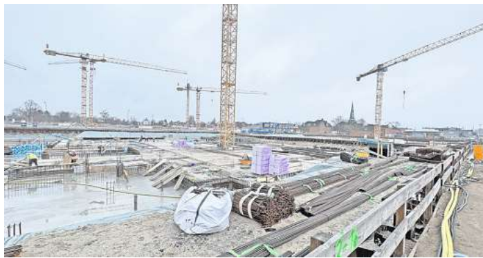
Viel Matsch, viel Grau: Im Bau Feld 1 entstehen derzeit die Bewehrungen für die Betonierarbeiten.
